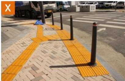
다른 시설물의 사용성을 고려하지 못한 설치
